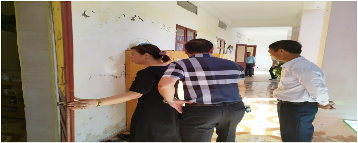
Đoàn khảo sát dãy nhà C bị xuống cấp
